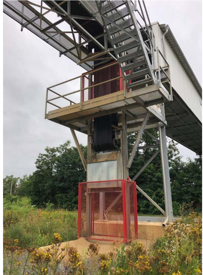
Bild 5: Schwerkraftspanneinrichtung, die mit Schutzgittern gesichert ist
