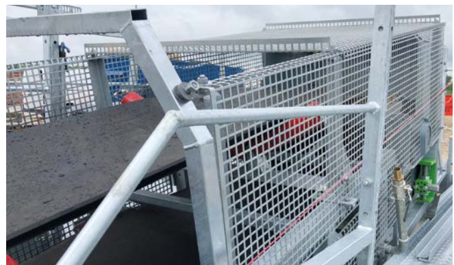
Bild 2: Schutzgitter an der Antriebstrommel
